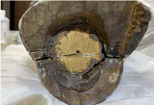
図 60：首 小材撤去前
